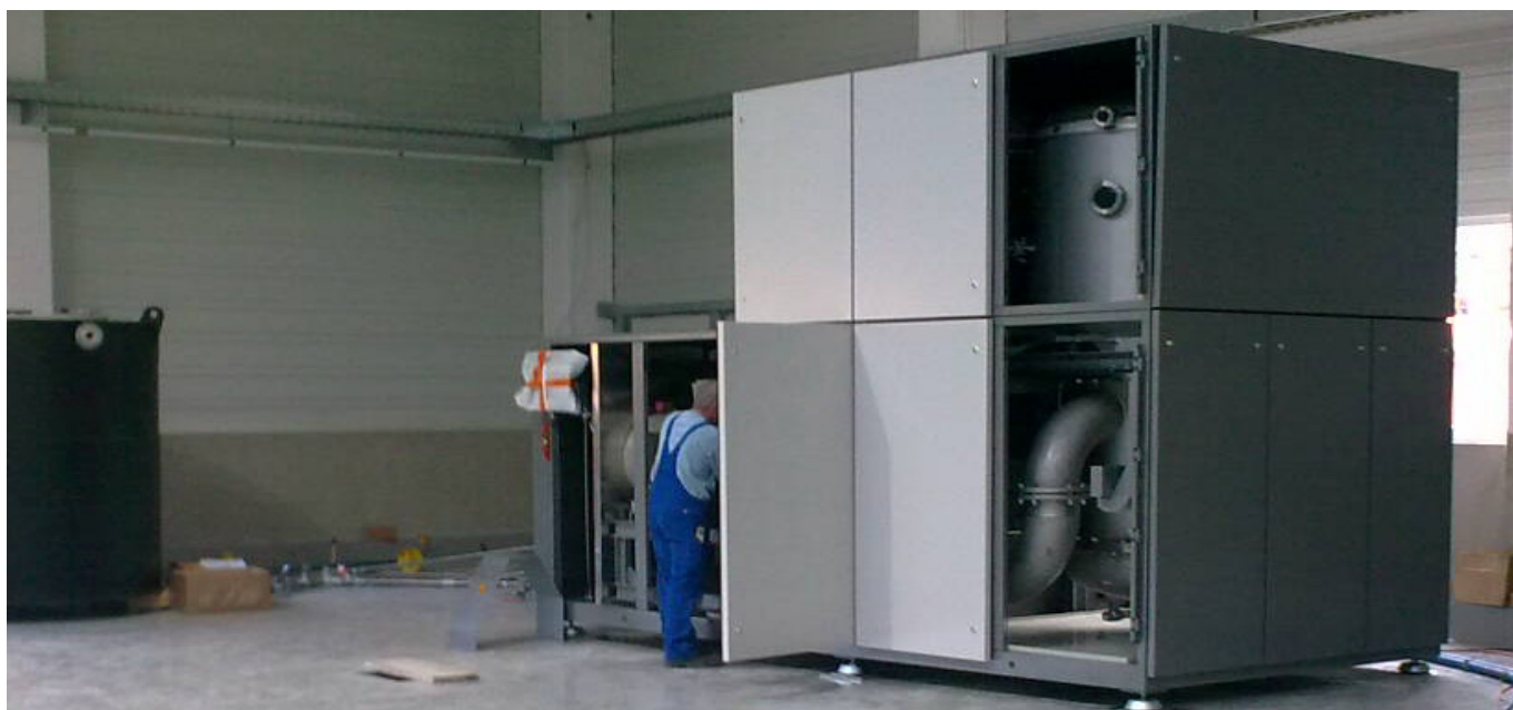
设备安装在新建建筑物内，用蒸发机的余热为公共区域和大厅供暖。
