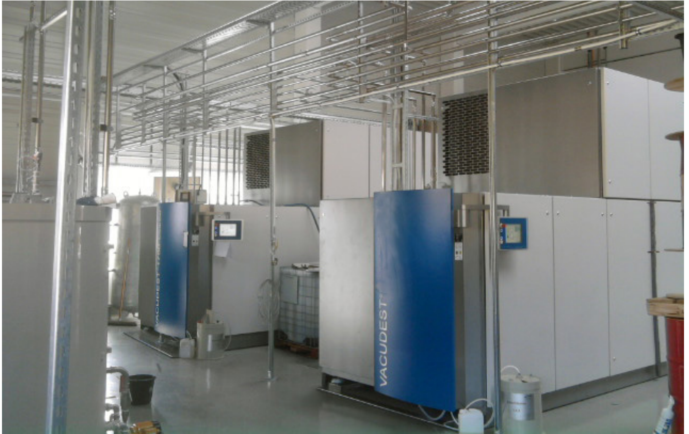
2台VACUDEST XL设备在ESA Entsorgungsservice可靠而环保地处理所有含油废水。
